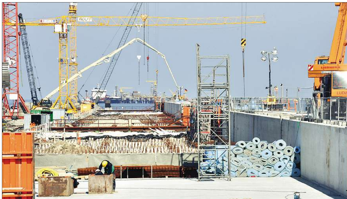
Auf der riesigen Baustelle des Wilhelmshavener Containerhafens Jade-Weser-Port wird intensiv gearbeitet. Wegen der Schäden an der neuen Kaimauer musste der offizielle Eröffnungstermin für den Hafen jetzt verschoben werden. BILD: JADE-WESER-PORT
